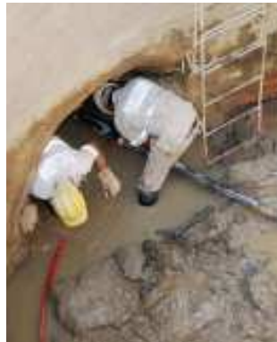
Data: 15/07/2010 - Rochas graníticas causam novamente dificuldades aos engenheiros e funcionários da obra da Sabesp
