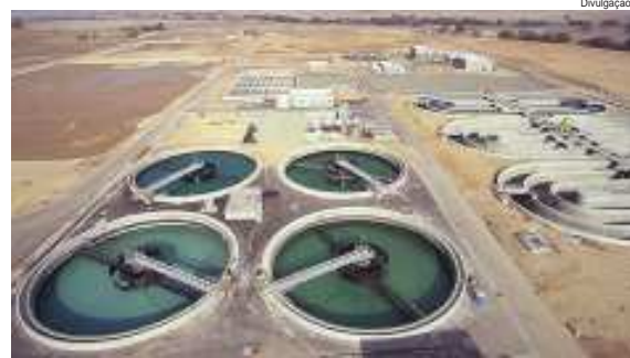
Exemplo de decantadores secundários
