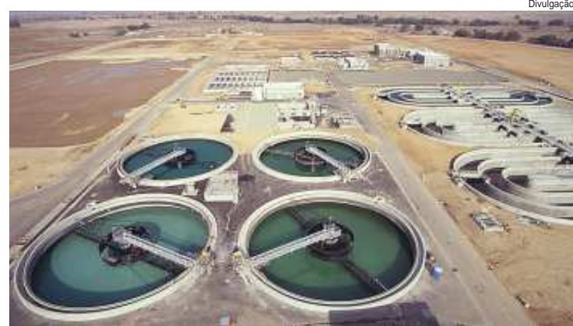
Exemplo de decantadores secundários
