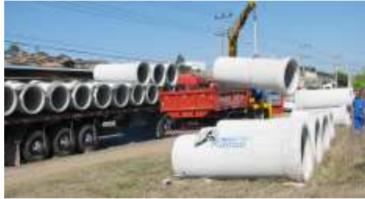
Data: 20/06/2009 - Chegada dos tubos que comporão a rede de coleta de esgoto
