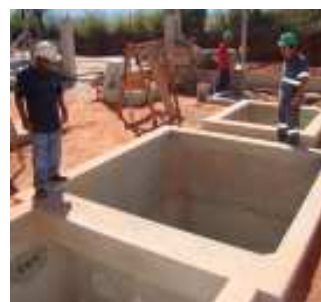
Data: 17/08/2011 - Estação elevatória que coletará e lançará os esgotos do Jardim Águas Claras e imediações para tratamento na Estação Central
