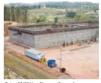
Data: 08/2011 - Obras estão em fase adiantada e a ETE começa a se tornar realidade em Bragança Paulista
