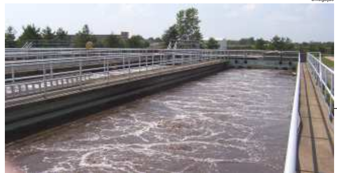
Exemplo de tanque de aeração
