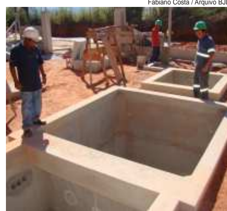
Data: 17/08/2011 - Estação elevatória que coletará e lançará os esgotos do Jardim Águas Claras e imediações para tratamento na Estação Central
